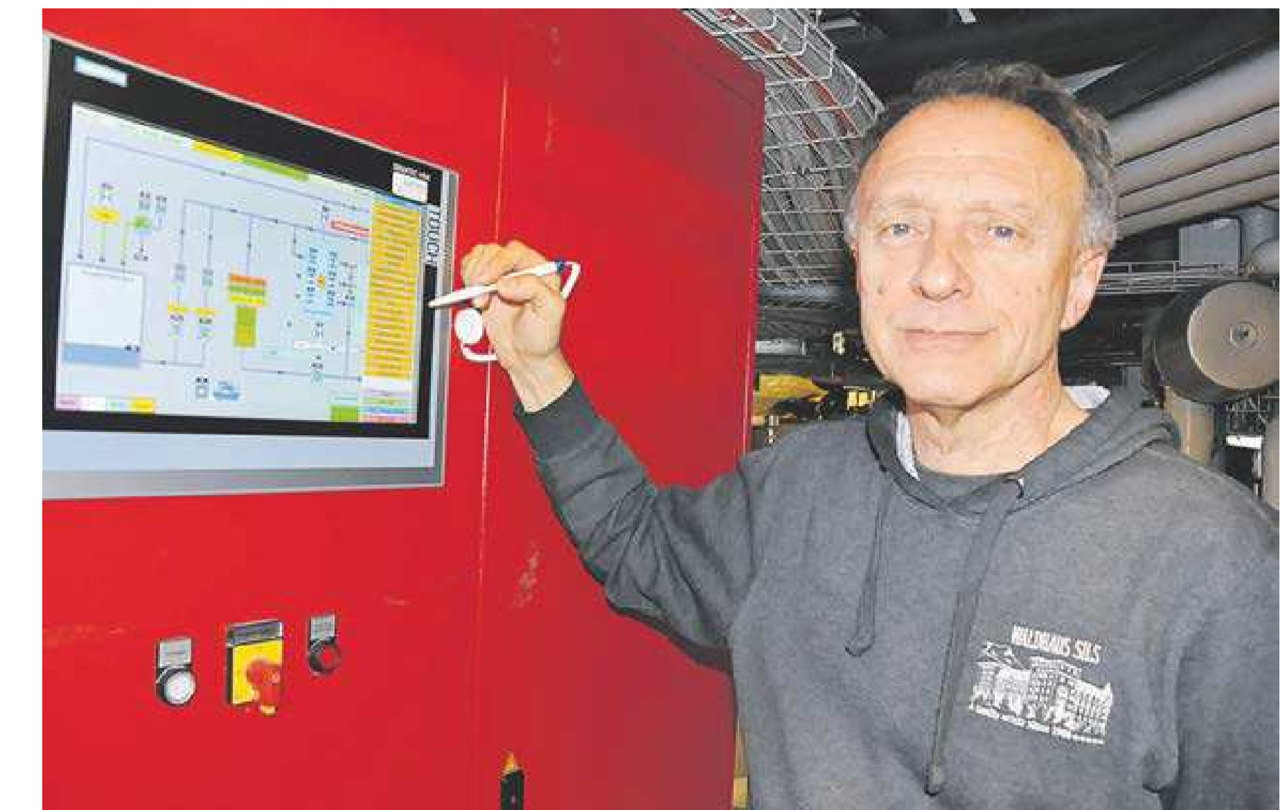
Im Technikraum des Spa-Bereichs: Guido Schmidt wacht über die Wasserqualität.
